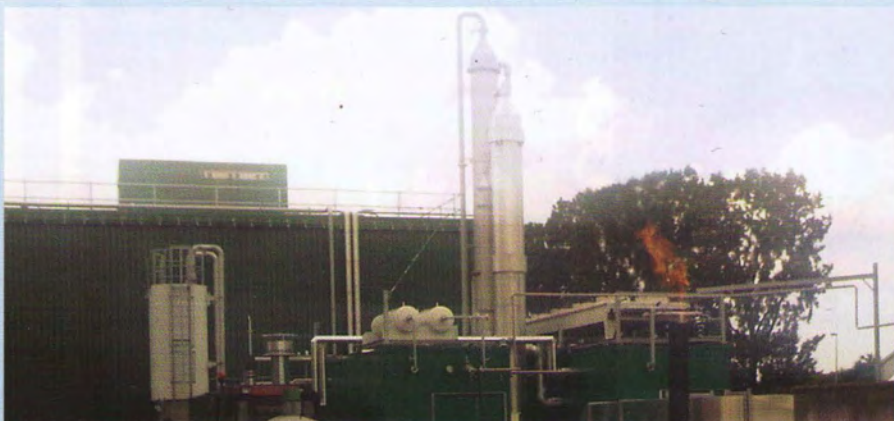
Opstartende vergistingsinstallatie met biogasopwerking Meerlanden
